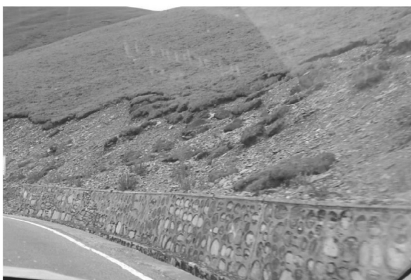
图 6 日喀则市浪卡子道路边坡上方的侵蚀情况(焦菊英摄于 20180826)
