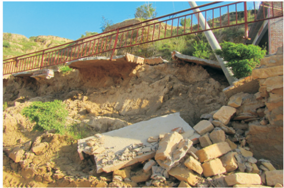
f 道路边坡坍塌
